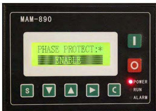
13. Zabezpieczenie zaniku/zamiany faz
