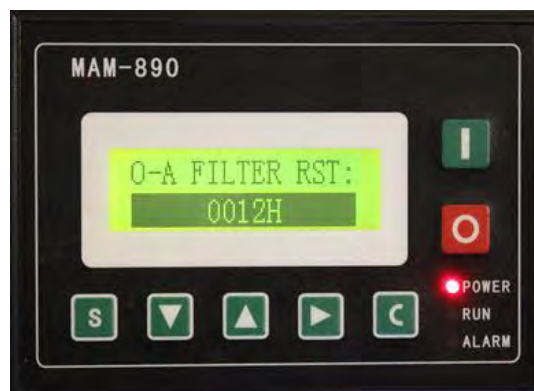
22. Zerowanie wymiany filtra separatora
