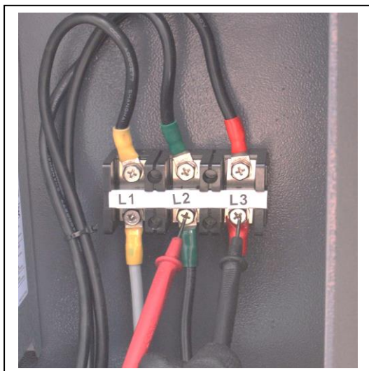
4. Pomiar napięcia prądu zasilania miernikiem
