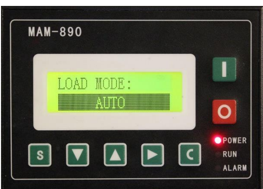
12. Załączanie sprężarki: AUTO/RĘCZNE
