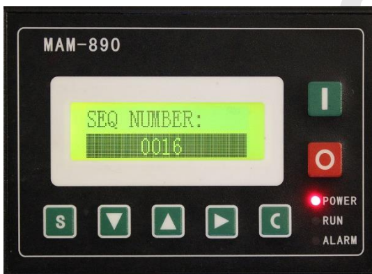
17. Ilość sprężarek podłączonych w sieci
