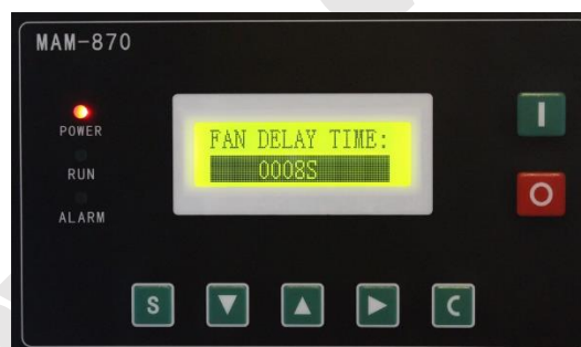
Czas opóźnienia uruchomienia wentylatora.
